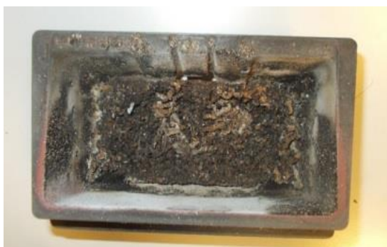
RUSZT KTÓRY WYMAGA CZYSZCZENIA
