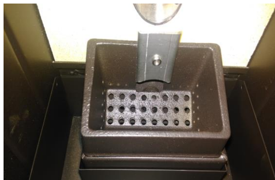
PRZYKŁAD NIEPOPRAWNEGO MONTAŻU
